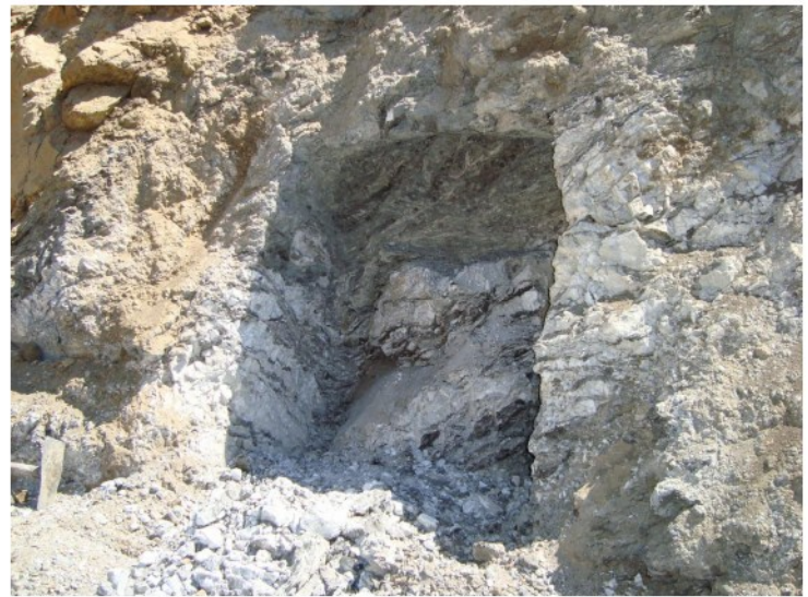
Рис. 4. Обрушенная призма с сформировавшейся очень сложной поверхностью обрушения
